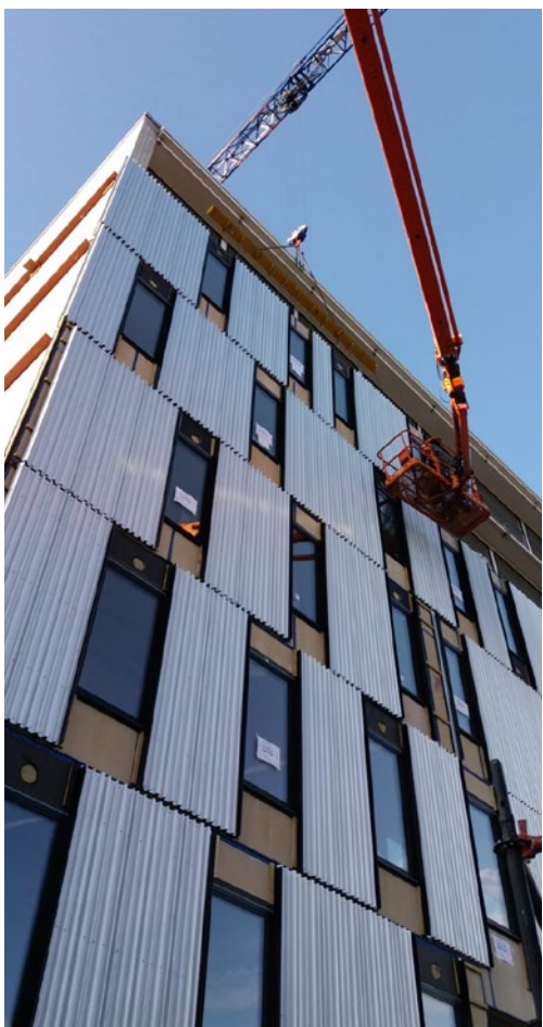
▲ Een kostenefficiënt voordeel van prefab: er zijn geen stellingen nodig. De kant-en-klare modules worden met een kraan en hoogwerker gemonteerd.
