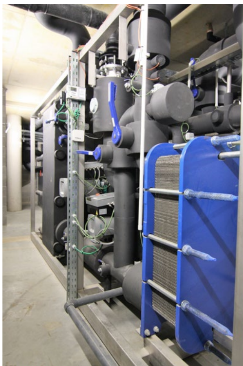
▲ De productiecentrale met warmtepomp, bron- en circulatiepompen en buffervaten werden bijna volledig in het atelier van Iftech geassembleerd.
